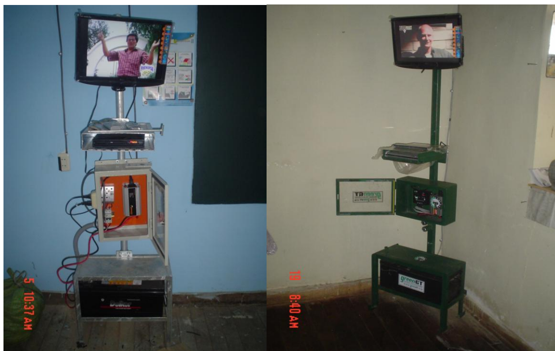
Vista general de los sistemas audiovisuales de carga especial, compuesto por un TV a color de pantalla plana a 220 VAC, un DVD a 12 VDC / 220 VAC, 12 W, inversor de 12 VDC a 220 VAC; instalados sobre una consola que forman una unidad con la caja porta batería-regulador
