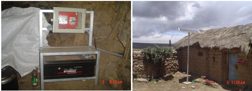
Izquierda, vista de otro sistema porta batería-regulador; derecha, vista general de la instalación de un panel fotovoltaico domiciliario
