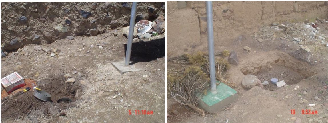
Vistas de conexión del sistema pozo a tierra en los sistemas fotovoltaicos domiciliarios
