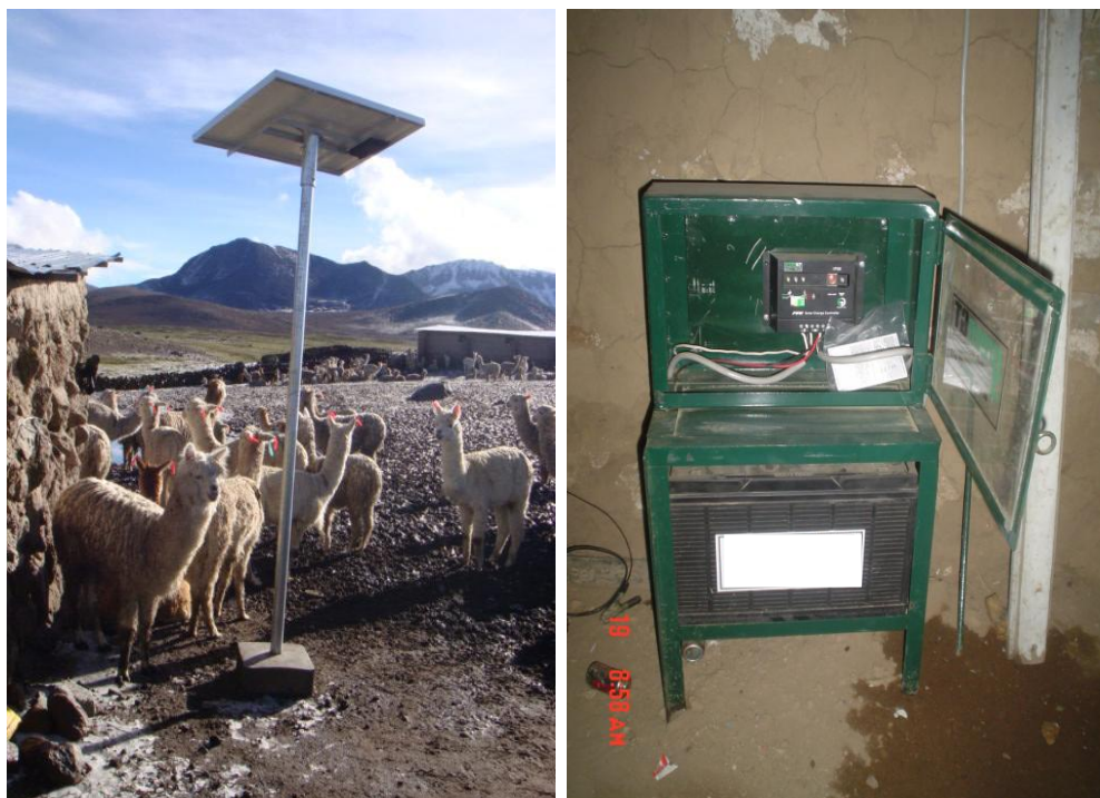
Izquierda, vista general de un panel fotovoltaico instalado sobre un rack metálico y soportado por un tubo metálico de F°G° sobre una base de cemento ciclópeo; derecha, sistema metálico porta batería-regulador
