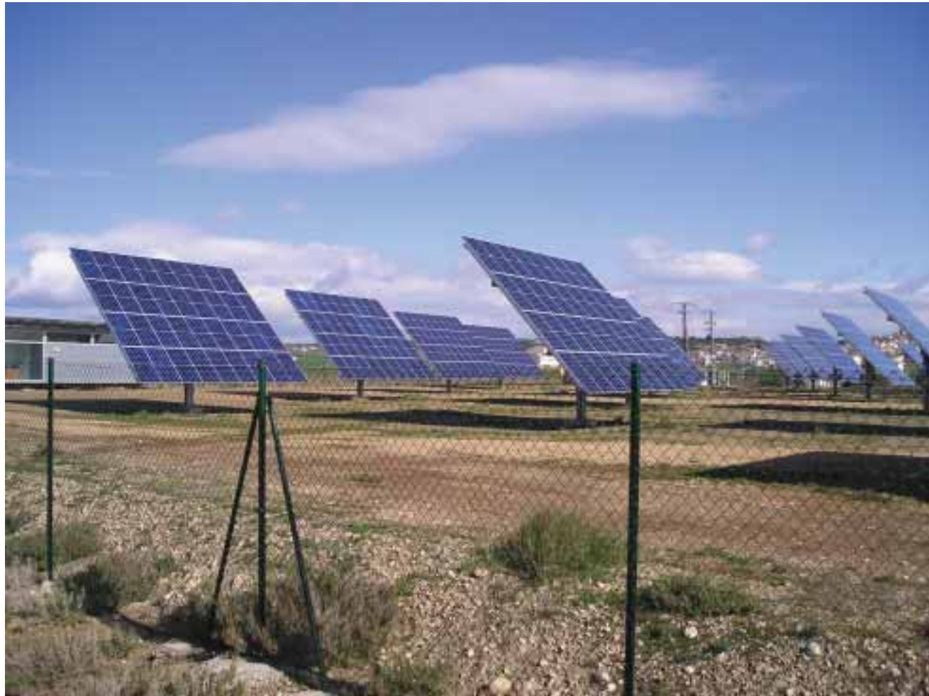
Instalación en Navarra (1,5 MW)
