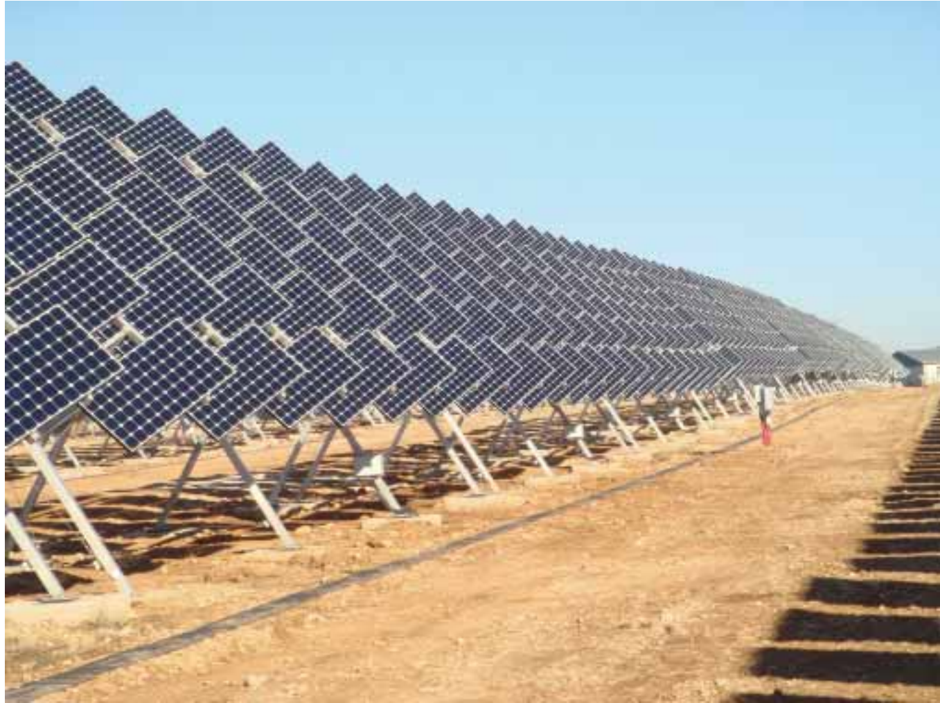
Instalación en Darro (5 MW)
