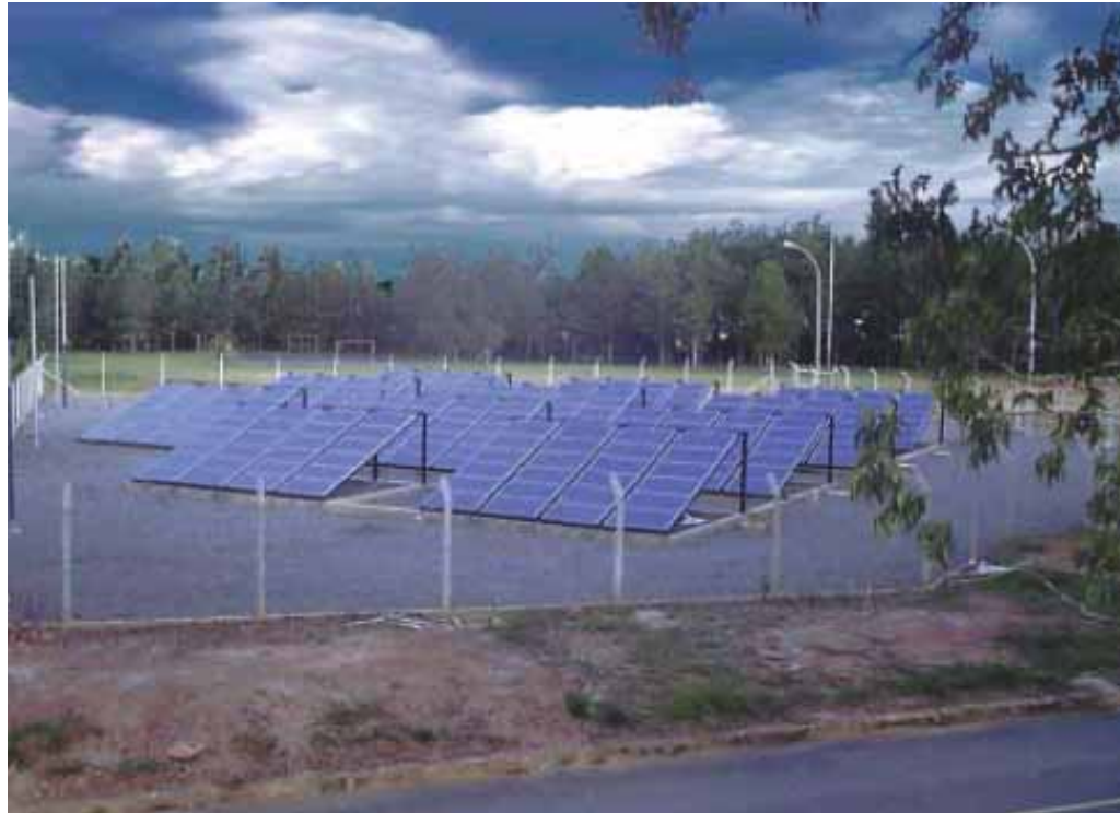
31,7 kWp de la Universidad Federal de Juiz de Fora
