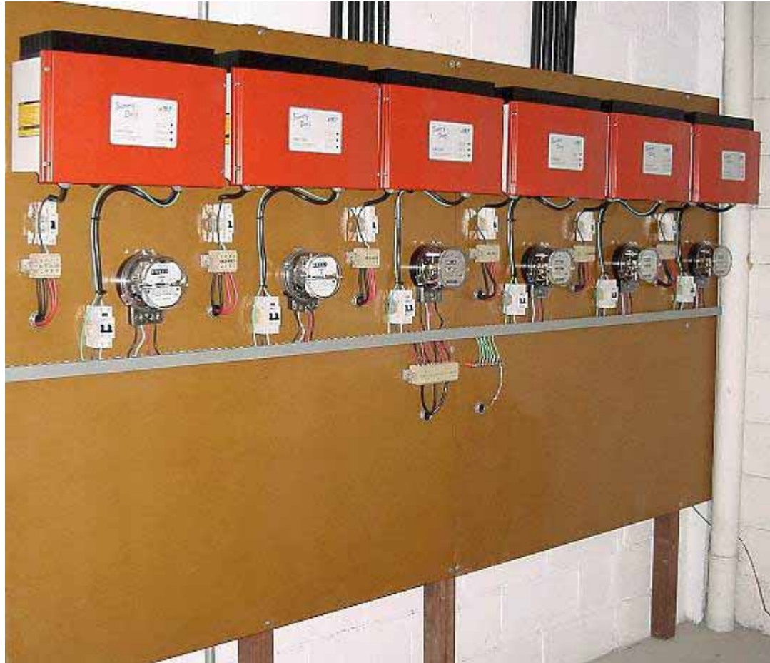
Instalación del Centro Pesquisas de Energia Elétrica – CEPEL-ELETROBRAS, Rio de Janeiro
