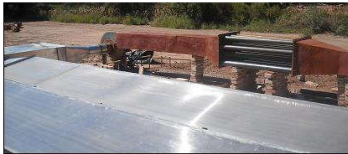
Figura 5: Detalle del intercambiador de calor y banco de colectores.
