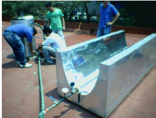
Figura 7.- Prueba de recirculación del agua en el sistema.
