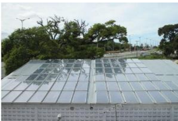
Figura 1. Campo de coletores planos com cobertura MIT instalado no Labrads/LES/UFPB.
