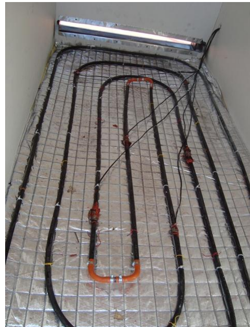
Figura 5- Imagen que muestra la configuración del piso radiante, materiales y los termopares con los cuales se hicieron las mediciones de las temperaturas
