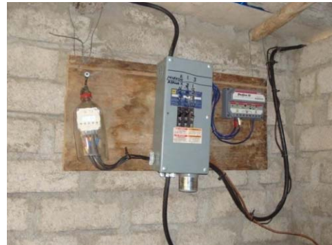
Fig. 1: Temporizador (izquierda), Controlador de carga (derecha) y caja de breaker (centro)
