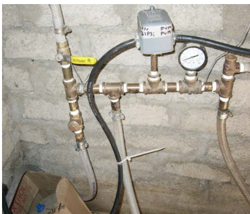
Fig. 2: Presostato o interruptor de presión (caja gris al centro) y tanque de expansión abajo a la derecha (tapón azul)
