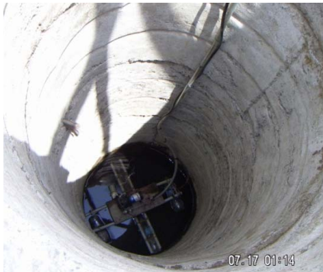
Fig. 3: Bomba de diafragma dentro del pozo (sin sumergir)
