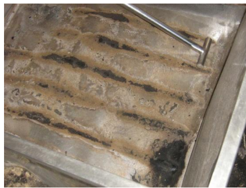
Figura 6. Estado de pailas
