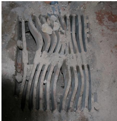
Figura 4. Deformaciones en la Parrilla
