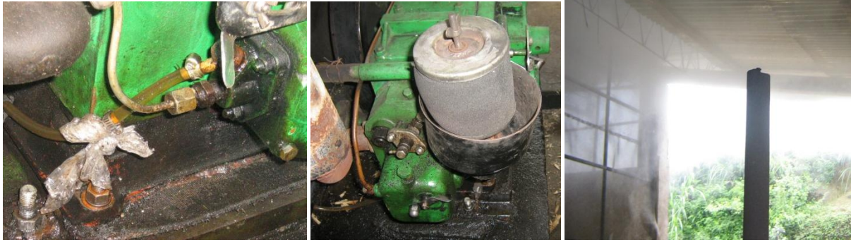
Figura 2. Deficiencias sistemas del motor y tubo de escape
