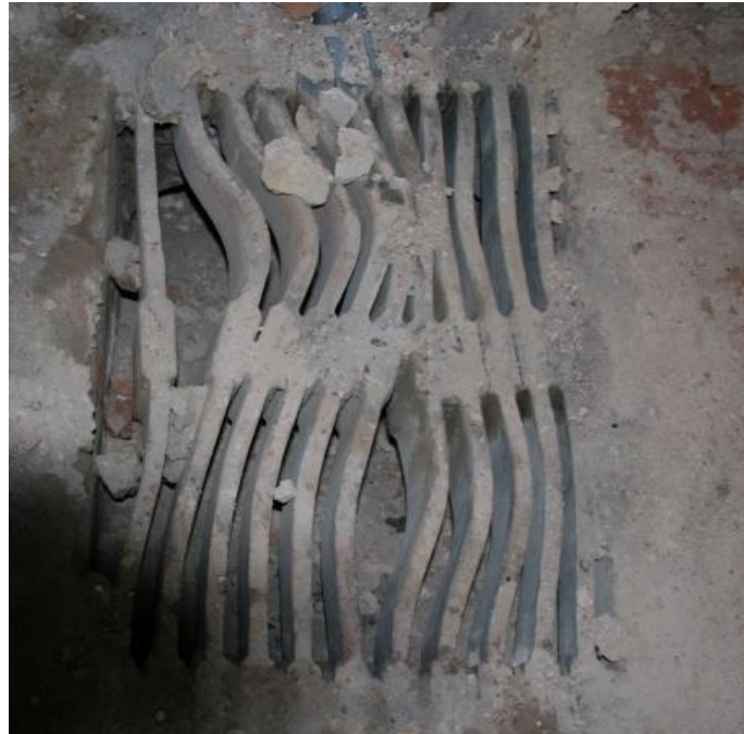
Deformaciones en la parrilla
