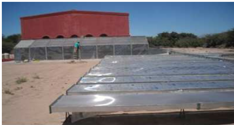
Figura 1- Banco de colectores de aire. San Carlos, Salta.
