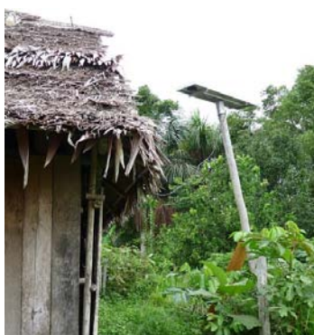
b) Estructura soporte torcida
